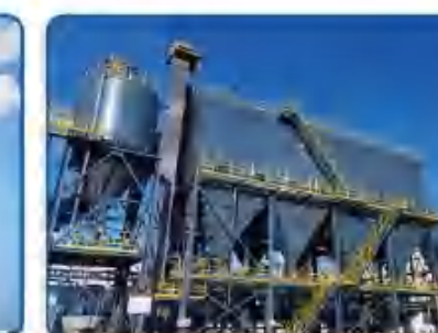
脱硫湿电一体化
