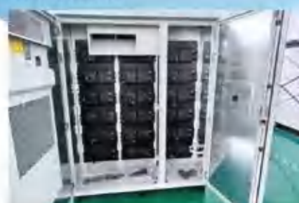
上海数据中心储能备电项目
