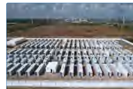
江苏如东丰储200MW/400MWh 共享储能项目
