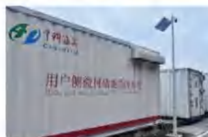
安徽用户侧微网储能项目
